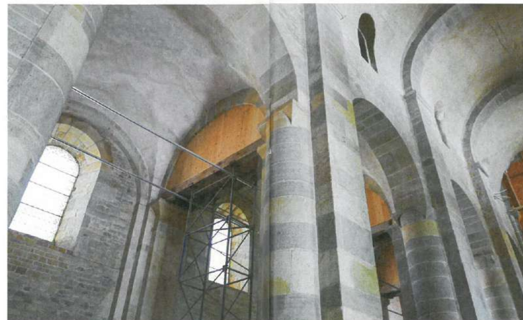
L'intérieur de l'édifice a aussi souffert de l'outrage du l'humidité. Quant aux ogives et chapiteaux ouvragés,
